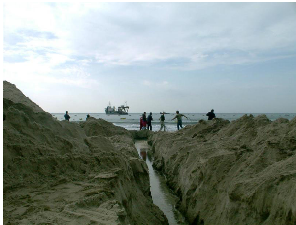
Figure C-11 : photographie montrant l'arrivée du câble électro-optique, reliant le détecteur à la côte, sur la plage des sablettes à La Seyne-sur-Mer (10 oct. 2001).
