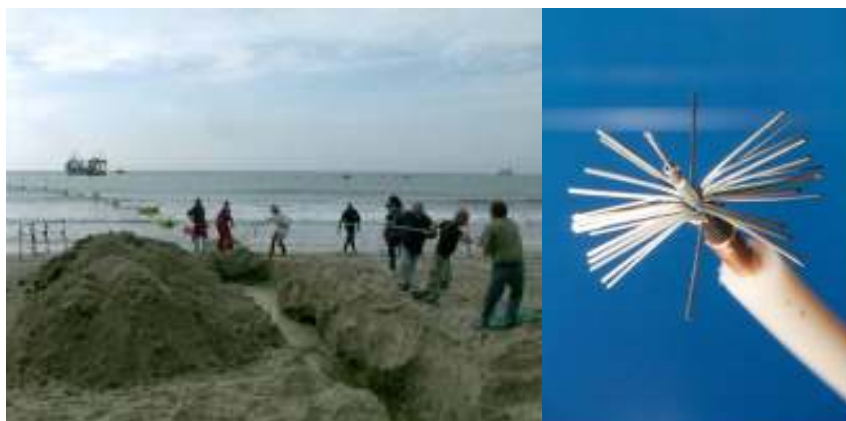
Figure B-24 : Photo de l'enfouissement sur la plage des Sablettes à la Seyne-Sur-Mer du câble électro-optique reliant le détecteur à la salle de contrôle (10 novembre 2001), à gauche. Photo d'une coupe du câble, à droite
