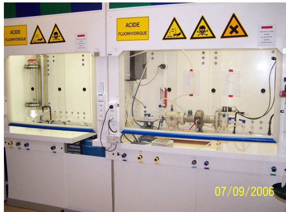
Figure 17 : Montage d'EP pour traitement de cavités mono-cellule installé au bâtiment 719 du CEA Saclay.
