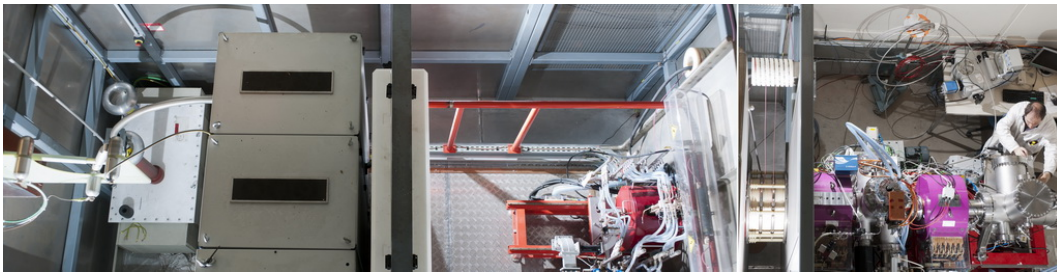
Figure 3.19 – L'injecteur LIPAc tel qu'installé dans le hall accélérateur du SACM au CEA
