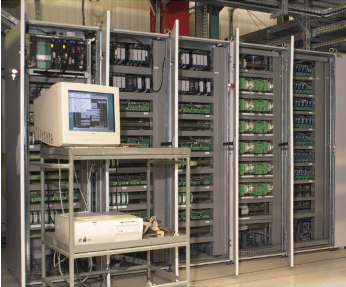
Figure 4-2 : Photo des baies.
