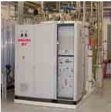
Photo du réfrigérateur Air Liquide installé dans les sous-sols de Neurospin avec en arrière-plan le stockage de 5000 litres d'hélium liquide.
