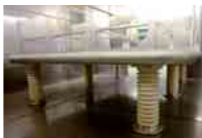
Plateforme à haute tension de l'injecteur du linac à protons installé à Saclay.
