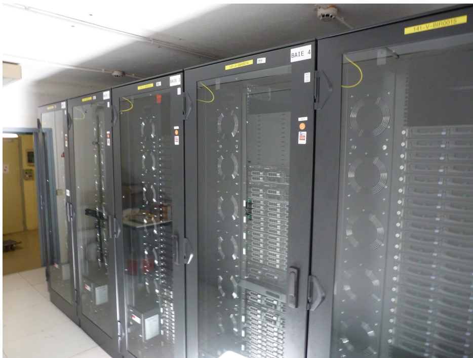
Serveur calculs + stockage + baies refrigerées
