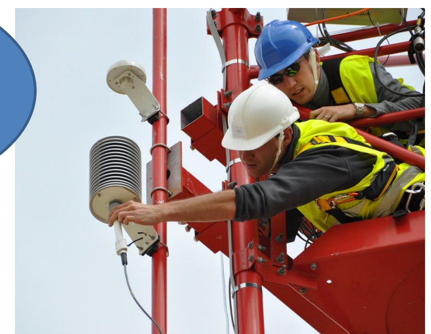
Juillet 2011 Raccordement des instruments météo
