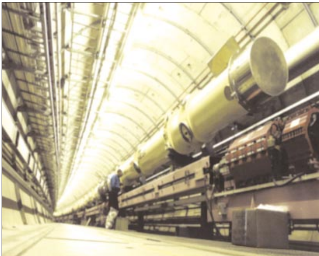
Photo. 2 : Une vue du tunnel du collisionneur Héra (6,3 km de tour). On distingue les deux anneaux superposés : les protons tournent dans celui du haut (en cours de montage), et les électrons dans celui du bas, en sens inverse.
