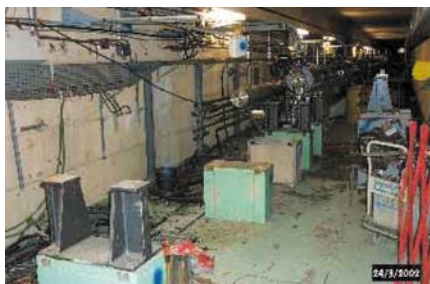
Le tunnel de feu de l'Accélérateur Linéaire de Saclay (ALS) enterré sous l'Orme des Merisiers, en cours de démontage.
