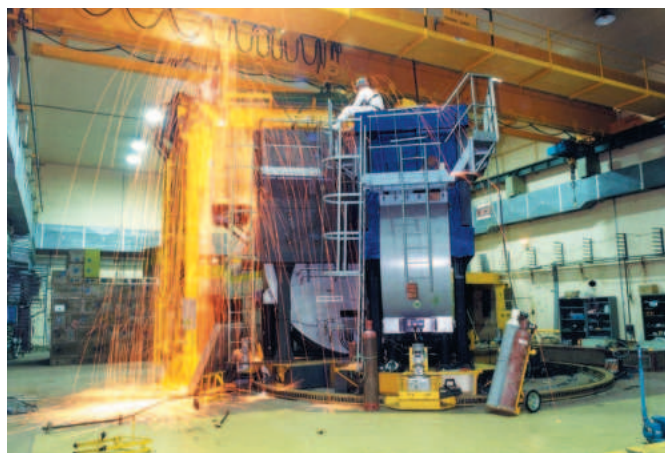
Démontage d'un spectromètre dans une salle expérimentale de l'ALS.
