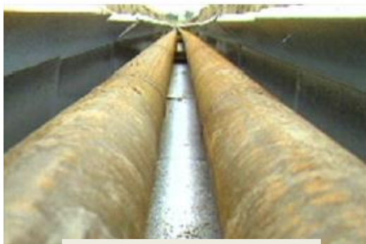
Ligne de transport
